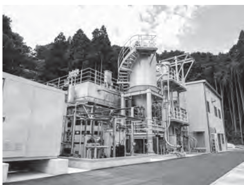
写真9 浸出液処理施設
