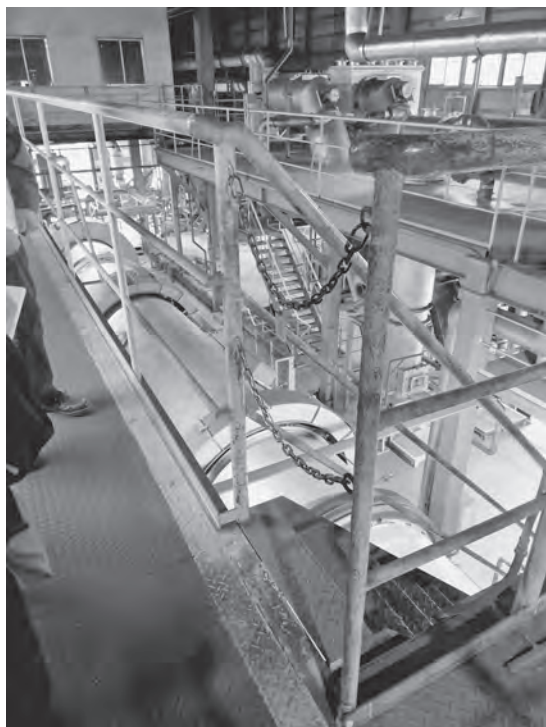
写真 3 ロータリーキルン：使用済み乾電池や水銀汚泥を処理するイトムカ鉛業所最大の焙焼・焼却施設
