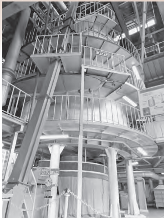
写真 2 ヘレシヨフ炉：水銀スラッジ、汚泥、吸着剤に含まれる水銀を抽出するための縦型多段式焙焼施設
