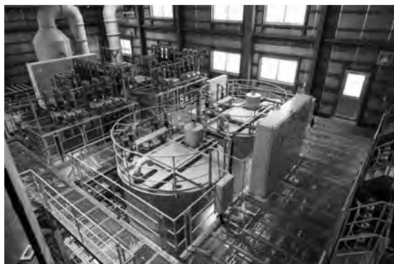
写真2 メインの反応槽エリア
