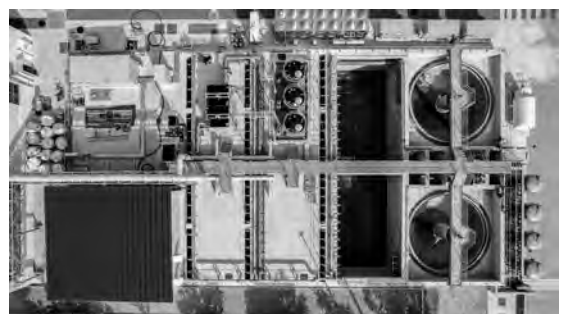
写真3 生物処理施設
