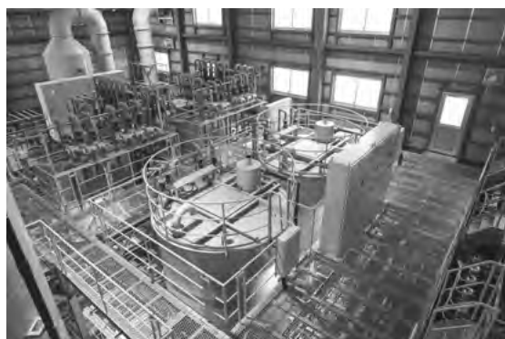
写真2 メインの反応槽エリア
